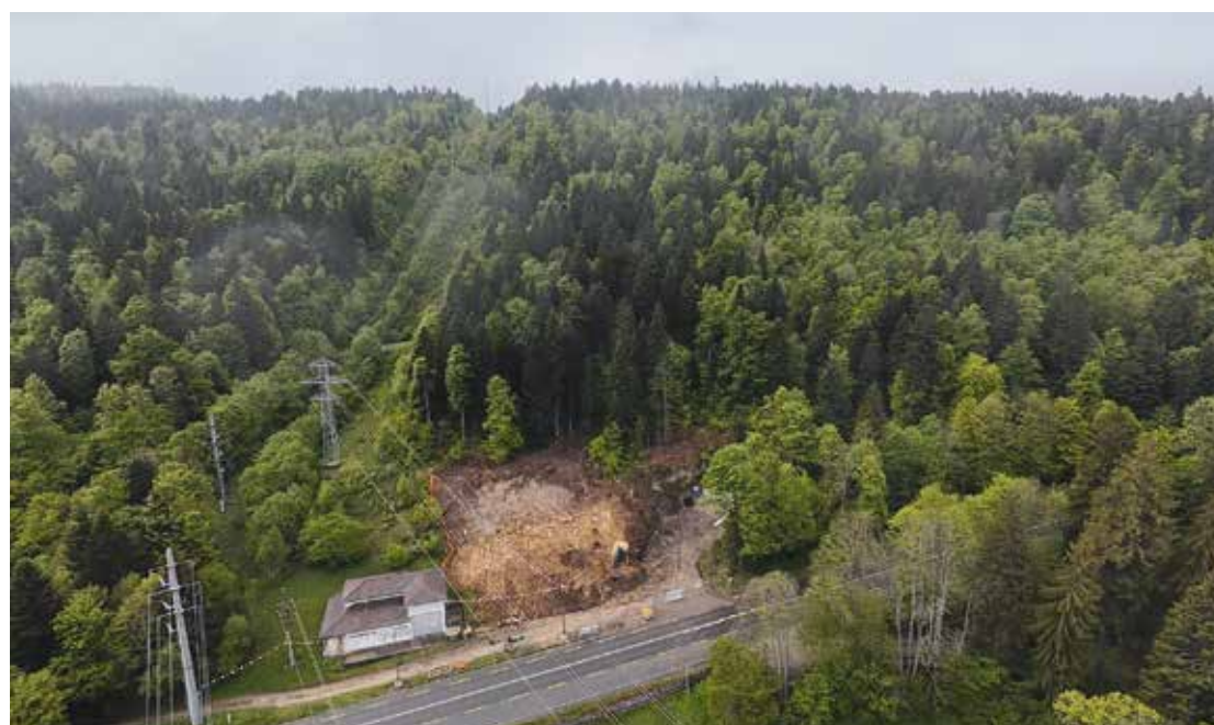
Les travaux préparatoires ont débuté aux Hauts-Geneveys. Le nouveau poste de transformation de Groupe E sera construit à côté de l'existant, qui sera ensuite démonté. Le défrichage est intégralement compensé par un programme de reboisement dans les forêts environnantes. Crédit: © Fabrice Reymond.
